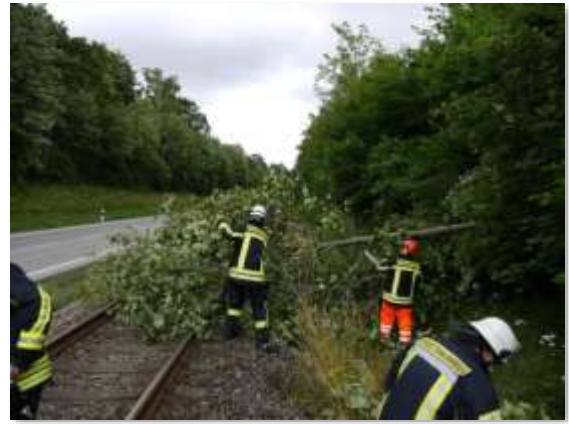
Baum über Gleisanlage 1
